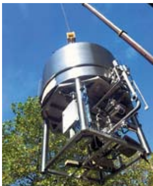
Der erste der drei Sudkessel.
